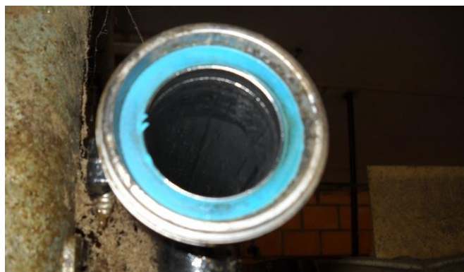
Abb. 11: Verschmutzte Verschraubung Schwenkbrücke
