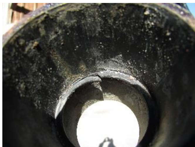
Abb. 10: Defekte Dichtung aus Milchleitung mit Ablagerungen
